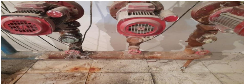
شکل ۳: وضعیت زنگ زدگی لوله و اتصالات پمپ فشار در پایگاه آمل
