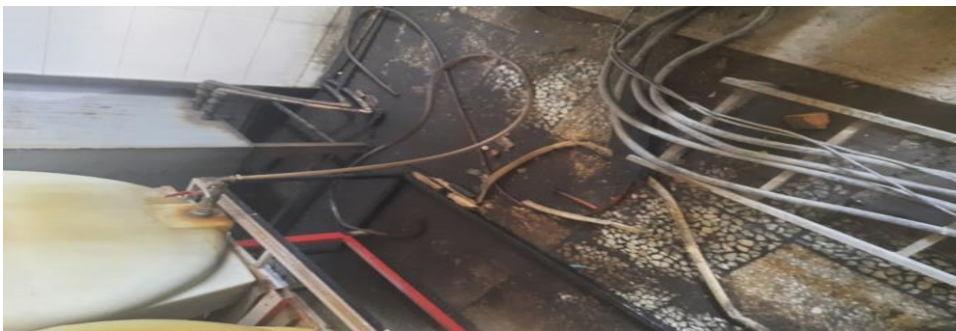
شکل ۴: یک نمونه از آغستگی جرم روغن در محل نگهداری مخزن و دیزل ژنراتور
